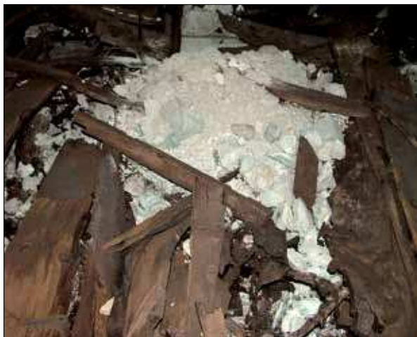
Рис. 302. Дюрбе Хаджи Герая. Склеп. Завал камней, разрушивший погребения 3–5. Фото 2008 г.
