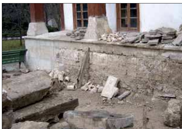
Рис. 215. Гаремный двор. Южный фасад Главного корпуса. Понижение грунта под Кофейной комнатой. Фото 2004 г.
